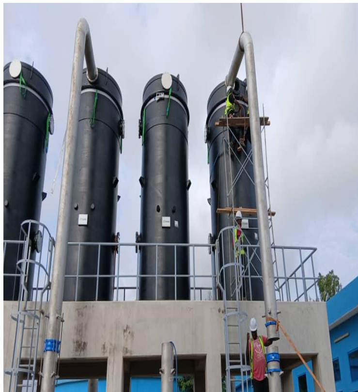
Tours de dégazage en PEHD à l'usine de Ouando / Porto-Novo
