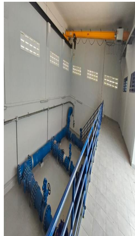
Salle des vannes et de la robinetterie de la station
