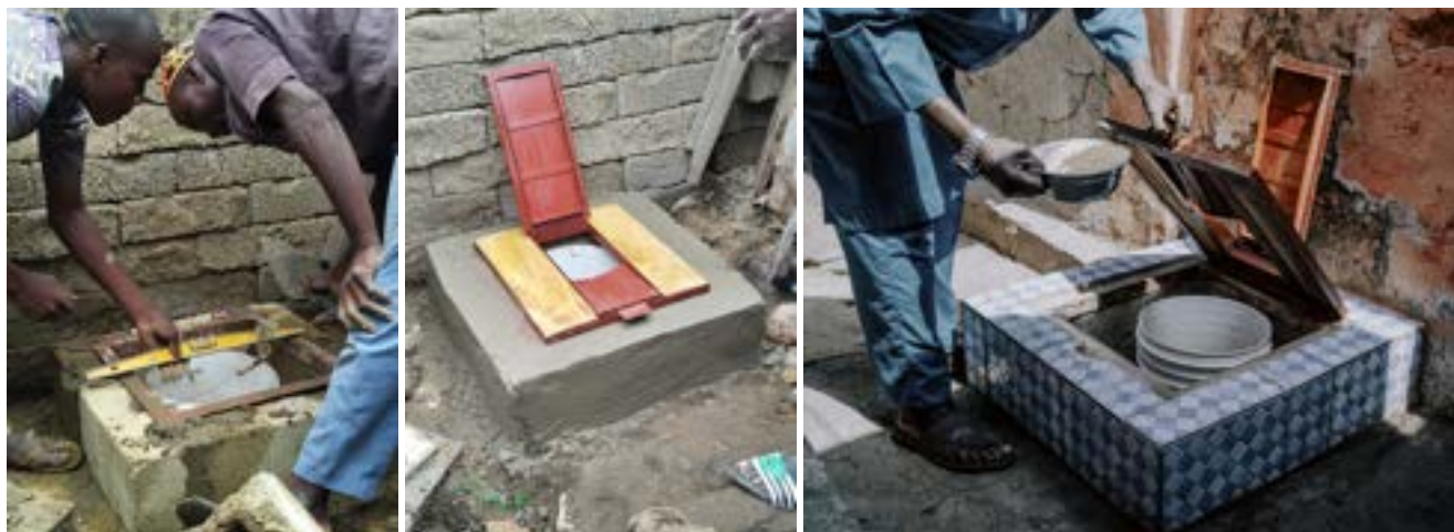
Installation d'une TAC et sciure après utilisation
