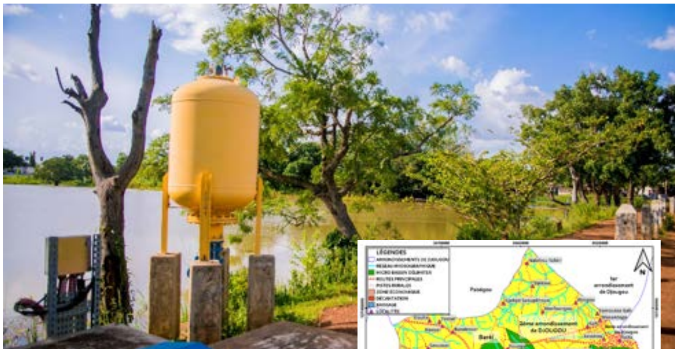
Equipements sur le site du barrage de Djougou
