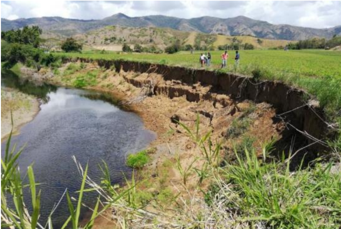
Rive de la Néra subissant d'importants phénomènes d'érosion – Nouvelle-Calédonie
